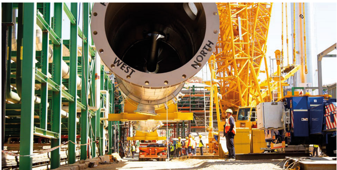
Obras de construcción de la primera planta de biocombustibles avanzados de Repsol en España.
