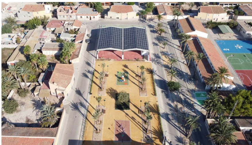
Vista aérea de la instalación fotovoltaica de El Realengo, en la comunidad energética de Crevillent (Alicante).
