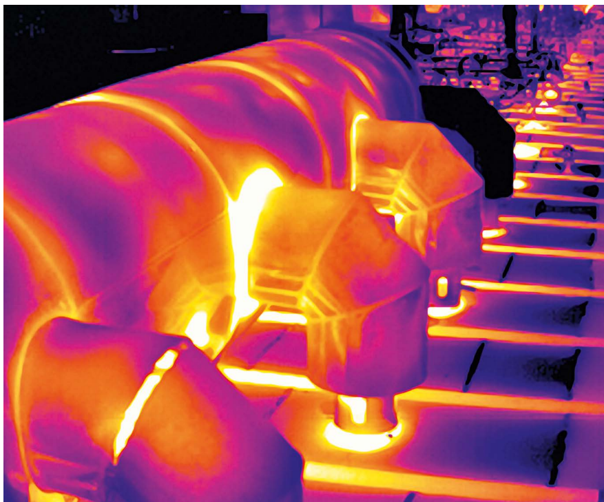
Las auditorías energéticas térmicas juegan un papel relevante en la evaluación de los sistemas de aislamiento de instalaciones.
