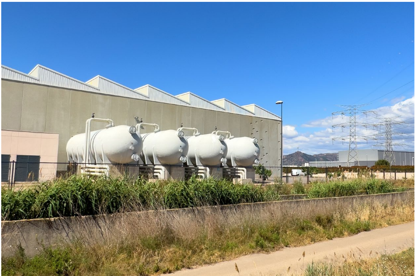
Planta desalinizadora de agua marina, ubicada en el Polígono Industrial del Puerto de Sagunto (Valencia). Foto: Shutterstock.
